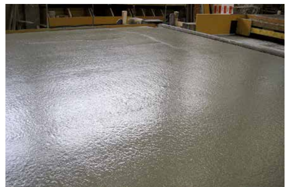
Abb. 1.3 Manuell bearbeitete Betonoberfläche
