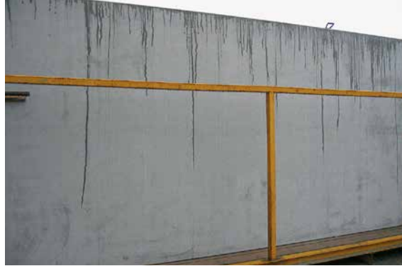
Abb. 5.4 Ungeschützte Lagerung: Wasserspuren
