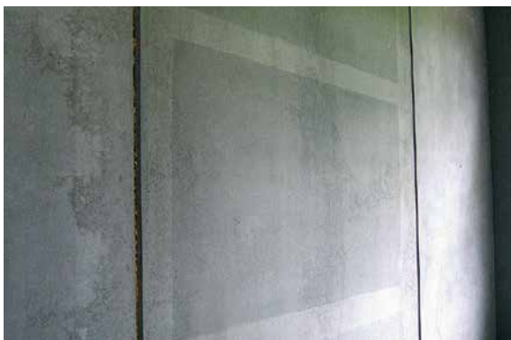
Abb. 4.6 Verfärbungen durch Trennmittelüberdosierung
