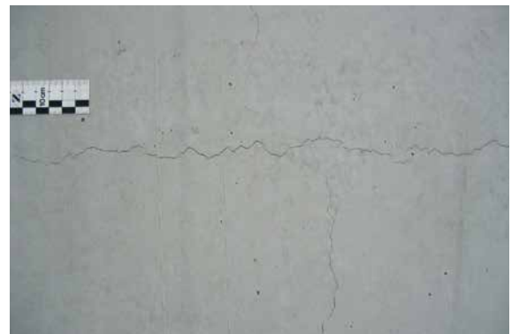
Abb. 9.2 Risse in einer Wand
