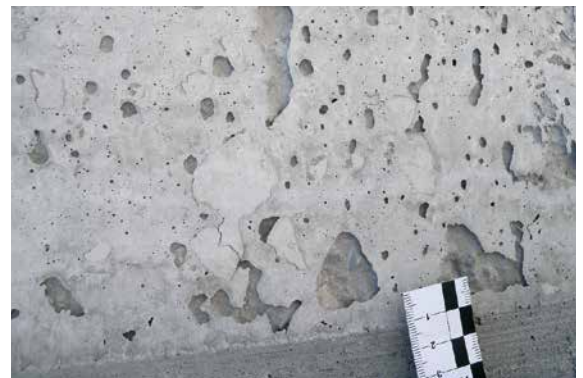
Abb. 2.4 Lunker an Laibungen
