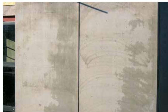
Abb. 1.2 Mögliches Resultat auf der Baustelle
