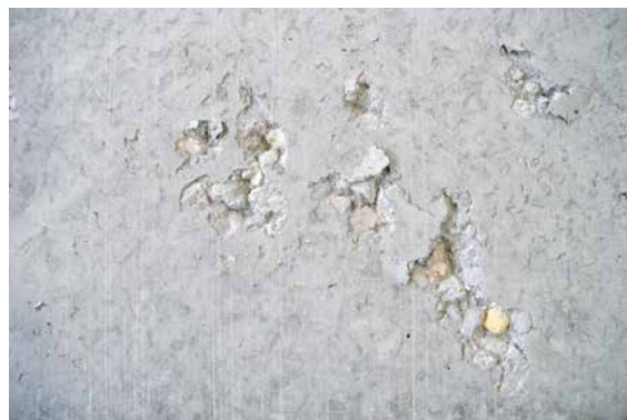
Abb. 4.7 Abrisse an Betonoberflächen
