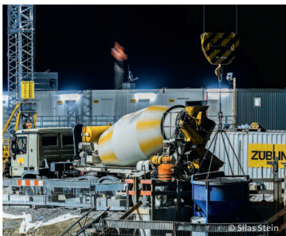
Im Durchschnitt kam Tag und Nacht alle 40 Minuten ein Fahrmischer mit dem Beton für zwei Füllungen des Betomaten auf die Baustelle.
