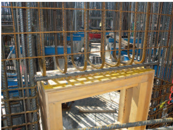
Aufgrund der vielen Einbauteile wurde die Körnung der Betonrezeptur des zweiten Gleitabschnitts reduziert.
