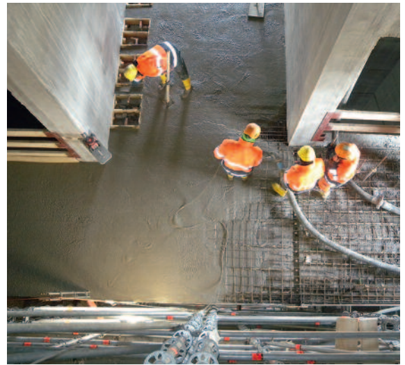
Einbringen des Betons einer Geschossdecke; der Baustoff muss dazu bis zu 240 Meter vertikal hochgepumpt werden.
